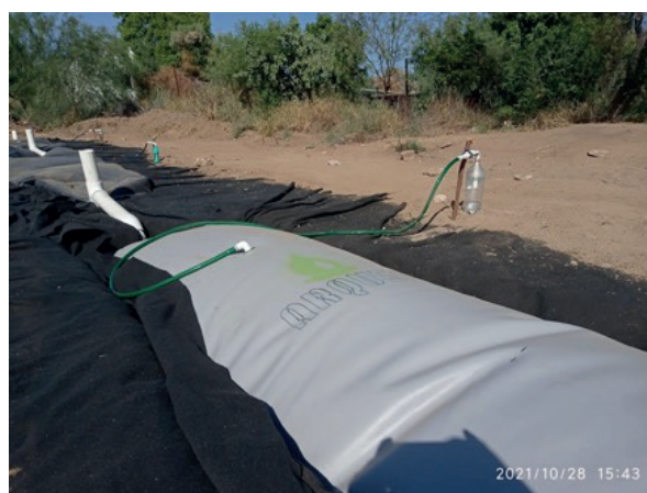
Figura 4. Biodigestor tubular construido con geomembrana de PVC, instalado en la posta porcina de la Universidad Autónoma de Baja California Sur. Archivo personal.
