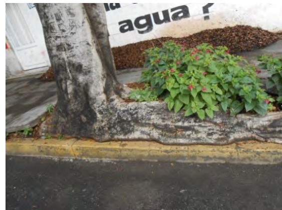
Figura 8. Levantamiento de banqueta por las raíces del árbol y abandono de basura en la vía pública.
