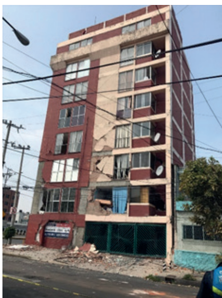
Figura 2. Daño en edificios provocados por demandas sísmicas en la Ciudad de México.
