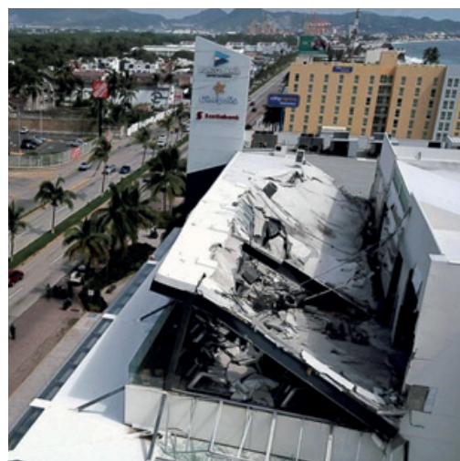
Figura 4. Daño por sismo en edificio en la zona epicentral en Manzanillo, Colima.
